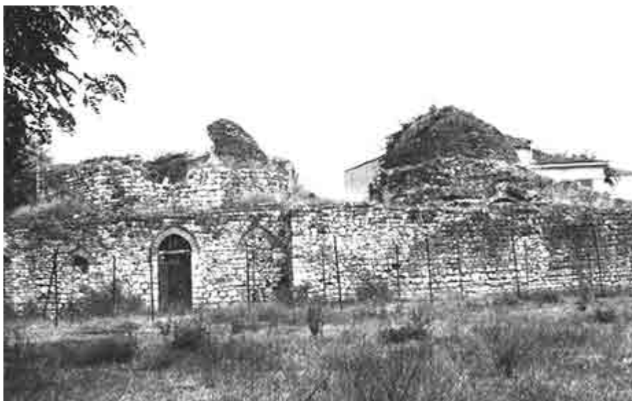
Εικ.: Το Χαμάμ Ιωαννίνων μετά την κατάρρευση του θόλου του ψυχρού χώρου.
