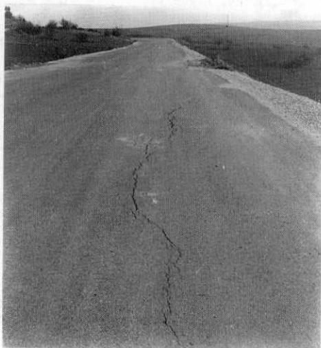
Φωτογρ.1. Διαμήκεις ρωγμές οδοστρώματος Photograph 1. Pavement's longitudinal cracks
