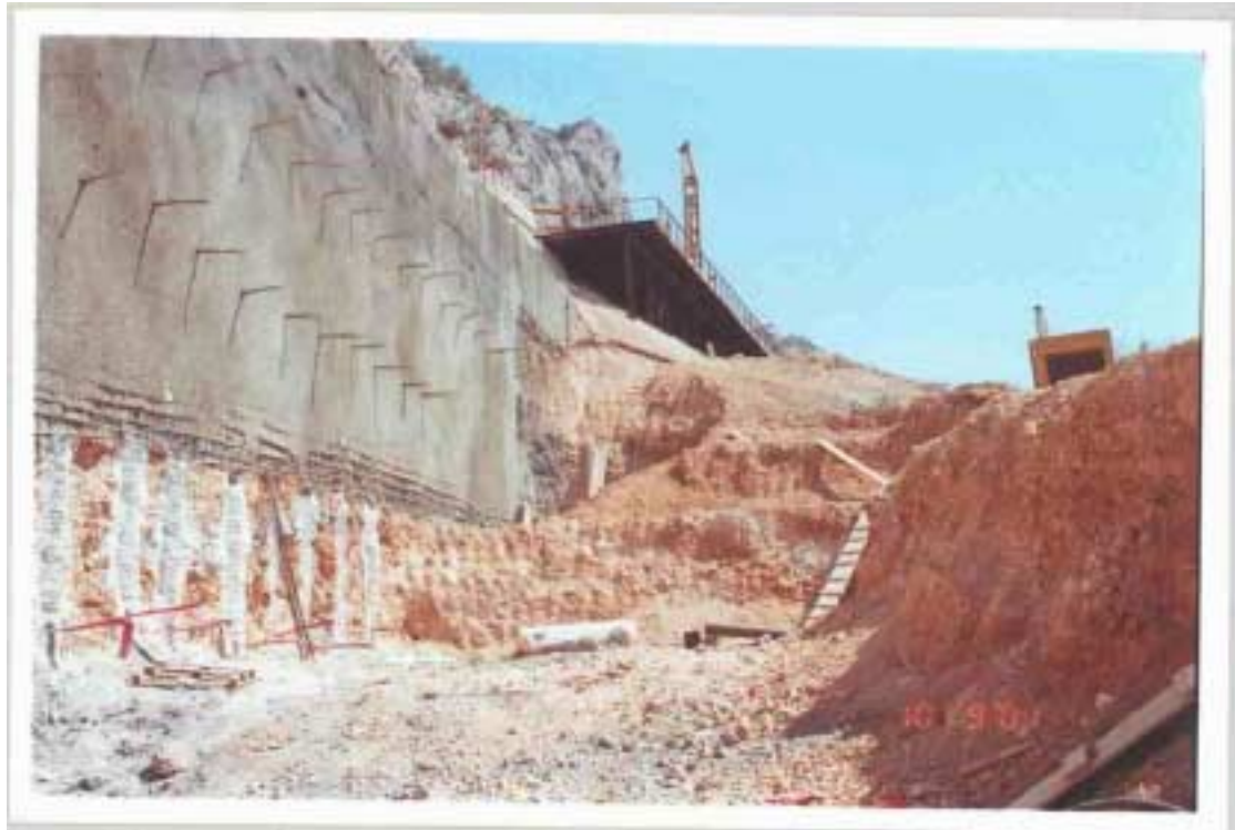
Μεταλλική εξέδρα χρησιμεύουσα ως δάπεδο εργασίας για την κατασκευή φρεατοπασσάλων του πασσαλοτοίχου αντιστήριξης Εθνικής οδού Αθηνών – Κορίνθου
