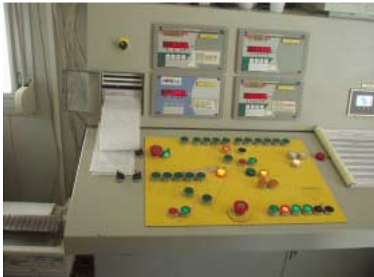
Φωτογραφία 4. Χειριστήριο Παρασκευαστηρίου Σκυροδέματος
