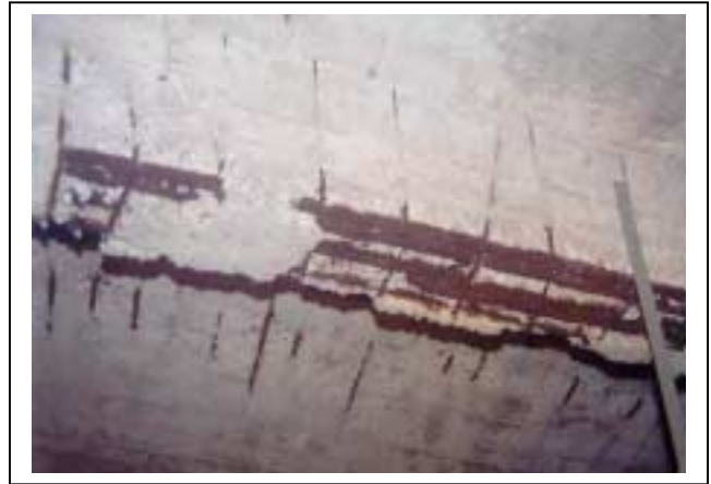
Εικόνα 5. Έντονες διαβρώσεις σε ζυγώματα σιδηροοπλισμού υπογείου
