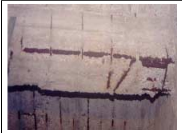
Εικόνα 4. Έντονες διαβρώσεις σε ζυγώματα σιδηροοπλισμού υπογείου
