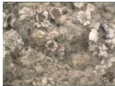
Εικόνα 4: Μεγέθυνση x25, δημιουργία εξανθήσεων αλάτων σε επιφάνεια σκυροδέματος σε θαλάσσιο περιβάλλον
