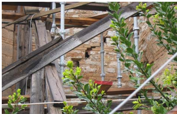
Σχήμα 2. Ζημιές στον ιερό ναό της Εισόδου της Θεοτόκου στο Αίγιο λόγω του σεισμού του 1995 (φωτογραφία του Κ. Σταματόπουλου στις 24/4/04).
