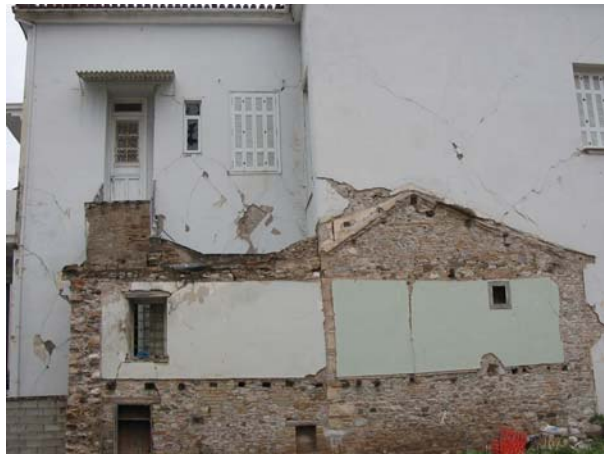
Σχήμα 1. Ρωγμές σε παλαιό κτίριο στο Αίγιο λόγω του σεισμού του 1995 (φωτογραφία του Κ. Σταματόπουλου στις 24/4/04).
