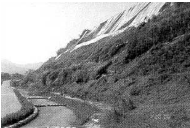
Φωτογραφία 3. Αστοχία του οπλισμένου πρανούς στο χώρο του Πανεπιστημίου Chi-Nan. Photograph 3. Failure of reinforced soil slope at the University Campus of Chi-Nan.
