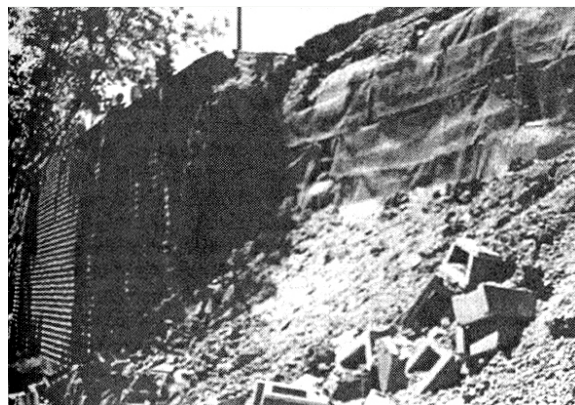
Φωτογραφία 2. Άποψη του τμήματος της δεύτερης αστοχίας.
