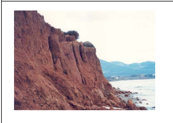
Φωτο 6. Αστοχία ολόκληρου του πρανούς από συνδυασμό ρωγμών εφελκυσμού, υποσκαφής και διάτμησης του εδάφους Photo 6. Failure of the whole cliff face due to a combination of tension cracks, undercut and shearing
