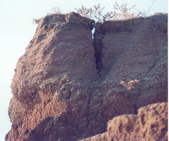
Φωτο 12. Ρωγμή εφελκυσμού στην κορυφή του πρανούς. Το τέμαχος ανατράπηκε με τις πρώτες βροχές Photo 12. Tension crack on the top of the cliff. The block toppled down in the first rain
