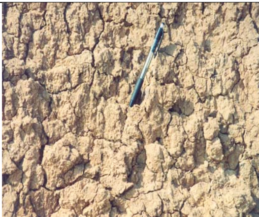
Φωτο 9. Μικρορωγμές στην επιφάνεια του πρανούς από την ξήρανση του εδάφους και τη δράση των αλάτων Photo 9. surface cracks due to dryness and salt crystallization
