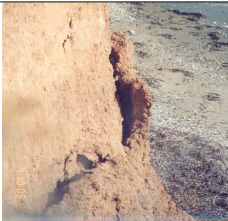
Φωτο 8. Ρωγμή εφελκυσμού στο μέτωπο του πρανούς. Photo 8. Tension crack on the face of the cliff
