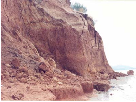
Φωτο 7 Ρωγμές εφελκυσμού στην κορυφή του πρανούς Photo 7. Tension cracks on the crest of the cliff.
