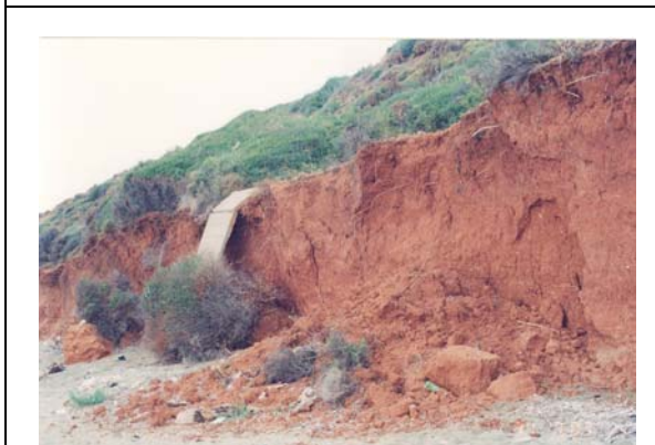
Φωτο 5. Αστοχία όλου του πρανούς λόγω ισχυρού κυματισμού σε σχετικά χαλαρές αποθέσεις. Photo 5. Failure of the whole cliff face in relatively loose deposits due to high waves.
