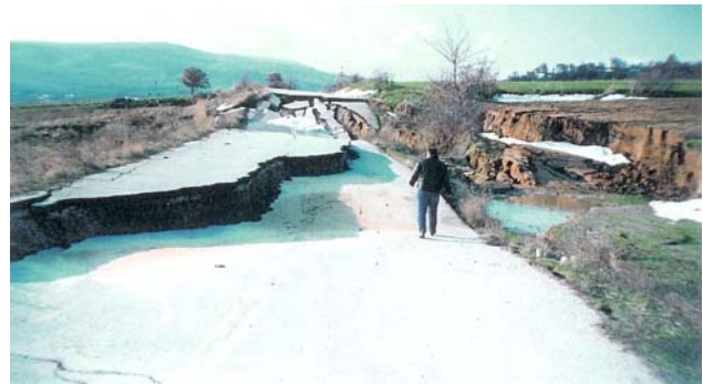
Φωτογραφία 1. Άποψη της αστοχίας στον Πεντάλοφο.
