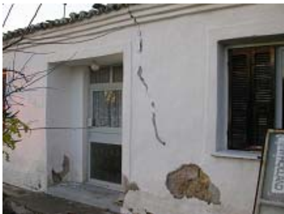
Εικ. 3. Διαμπερής διατμητική αστοχία κτιρίου από φέρουσα τοιχοποιία.
