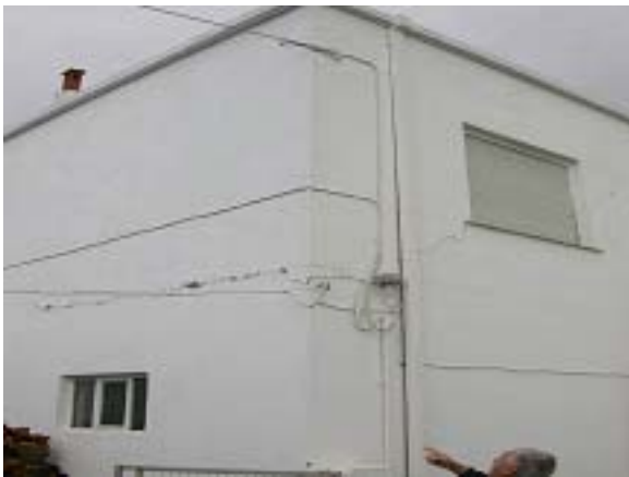
Εικ. 9. Βλάβες σε γωνιακό κόμβο.
