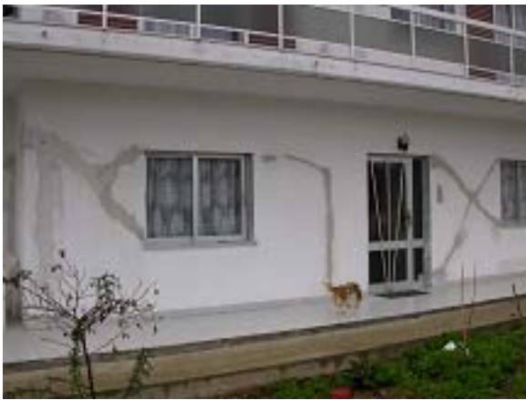
Εικ. 7. Κατακόρυφες και χιαστί διατμητικές ρωγμές τοιχοπληρώσεων σε κτίριο από Ο/Σ.
