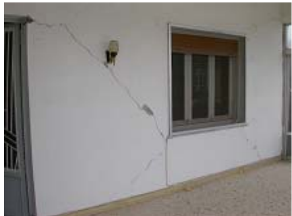
Εικ. 8. Διαγώνιες αστοχίες πεσσού τοιχοποιίας μεταξύ δύο ανοιγμάτων.
