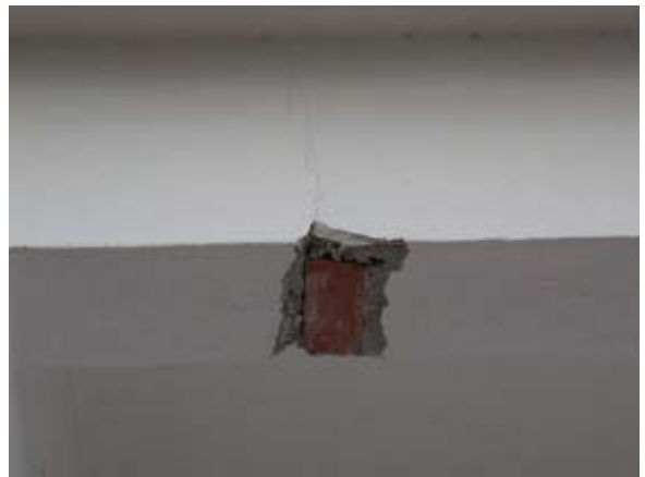
Εικ. 10. Διατμητική αστοχία δοκού.
