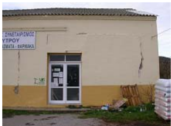
Εικ. 12. Αποκόλληση τοιχοποιίας και αστοχία κόμβου λόγω εμβολισμού τοιχοποιίας.
