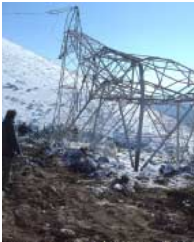
Φωτ. 3. Κατεστραμμένος πύλωνα.
