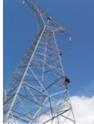
Φωτ. 18. Εργασίες ανέγερσης πύργων και ενσυρμάτωσης της γραμμής μεταφοράς μετά την πάροδο των τριών ημερών από την ημερομηνία σκυροδέτησης των βάσεων θεμελίωσης.
