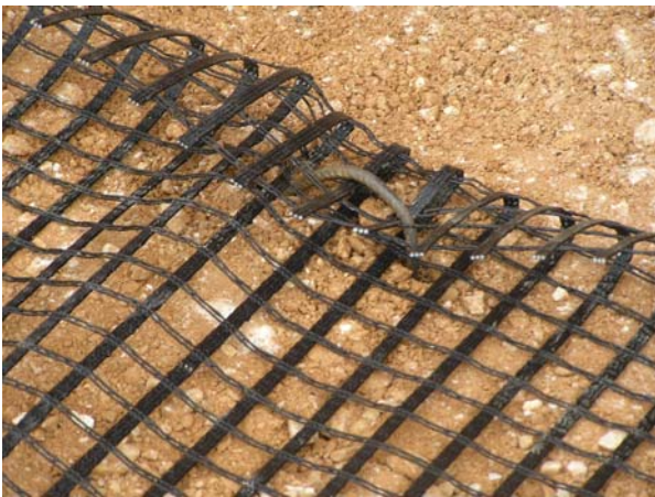
Φωτ. 8: Αγκύρωση του γεωπλέγματος με σιδηρές ράβδους (J-pin) Picture 8: Anchorage of the reinforcement strip using metal pins (J-pin)
