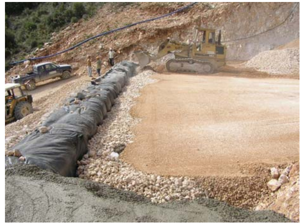
Φωτογραφία 9: Διάστρωση & συμπίκνωση υλικού επίχωσης Picture 9: Spreading and compaction of fill material
