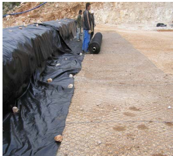
Φωτ. 6: Τοποθέτηση 1 ου γεωπλέγματος Picture 6: Installation of the 1 st geosynthetic reinforcement strip
