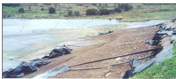
Φωτ. 2: Άκρο υψηλού αναχώματος με κατεστραμμένη την μεμβράνη και άθικτο το σωληνωτό σύστημα αγκύρωσής της.
