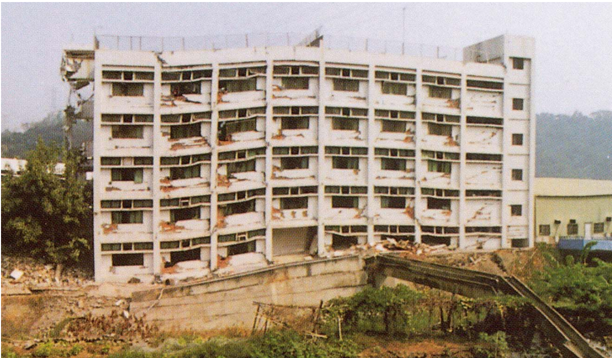
Σχήμα 1. Παράδειγμα αλληλεπίδρασης διάρρηξης–εδάφους–κατασκευής από τον σεισμό του Chi-Chi, Ταϊβάν 1999 : πενταόροφο κτιρίου του Κολεγίου Tze-Min στο Wu-Fung Hsiang [Hwang, 2000].
