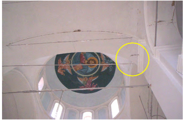
Σχήμα 7. Αστοχία μεταλλικού ελκυστήρα στον Ι.Ν. Αγ. Τριάδος στα Μητάτα.
