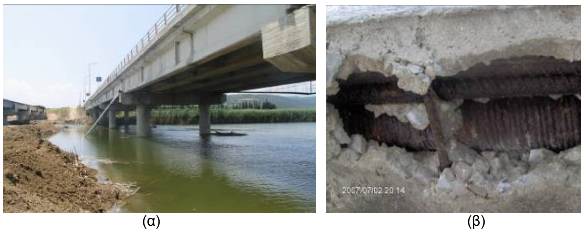
Σχήμα 2. Φθορές ποταμογέφυρας Στρυμόνα (α) Άποψη, (β) ακραίες δοκοί.
