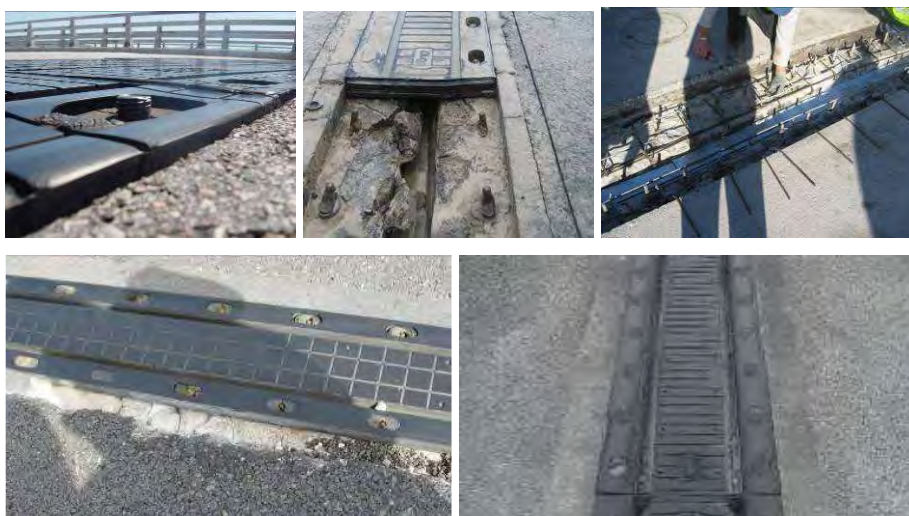
Σχήμα 3. Χαρακτηριστικές βλάβες και επισκευές ελαστομεταλλικών αρμών
