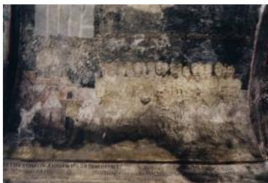
Εικόνα 3: φθορά λόγω φωτιάς
