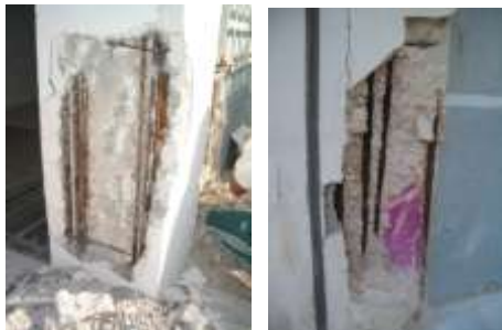
Σχήμα 3. Δτάβρωση ουλτισμού κατακόρпкаων στοτχηίω
