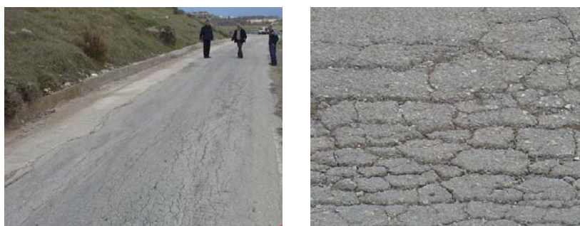
Σχήμα 6. Ρηγματώσεις υφιστάμενου εύκαμπτου οδοστρώματος
