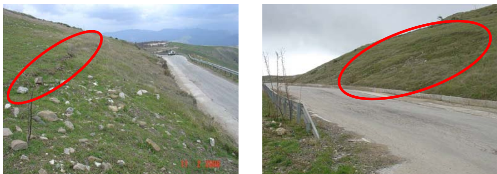
Σχήμα 5. Ορατά ίχνη ερυσμού στην περιοχή του υφιστάμενου δρόμου
