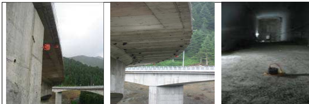
Σχήμα 4. (α), (β) Ανακλαστήρες, (γ) Τριαξονικά επιταχυνσιόμετρα κιβωτιοειδούς φορέα
