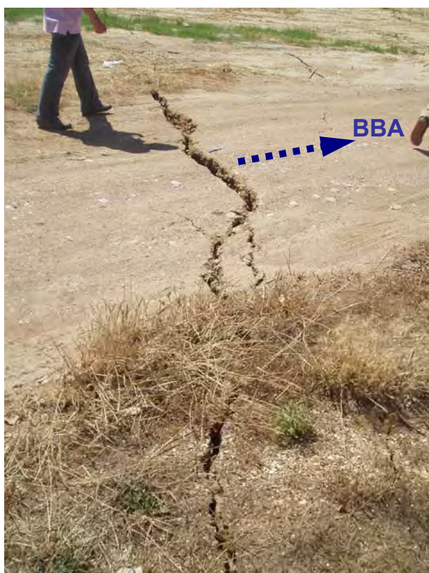
Σχήμα 9. Χαρακτηριστική επιφανειακή ρωγμή στην παραλιακή ζώνη της Κ. Αχαΐας (Θέση I: ανατολικό τμήμα) μετά το σεισμό της 8-6-2008, υποδεικνύοντας μετακίνηση με κατεύθυνση BBA .
