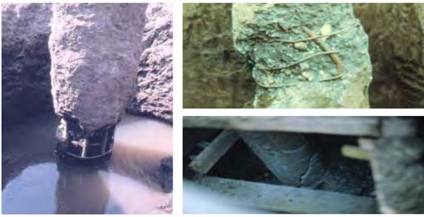
Φωτογραφία 1. Κατασκευαστικά ελαττώματα πασσάλων
