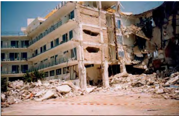
Σχ. 1. Κατάρρευση της κεντρικής πτέρυγας του ξενοδοχείου «Ελίκη», κατά το σεισμό της 15/06/95.
