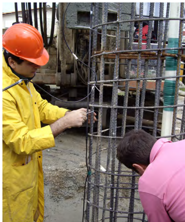
Φωτογραφία 2. Εγκατάσταση αισθητήρων οπτικών ινών Photograph 2. Installation of fiber optic sensors during the disposition of reinforcing cage
