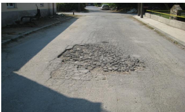
Εικ. 1 : Ρηγματώσεις στο οδόστρωμα επί ανώνυμης οδού
