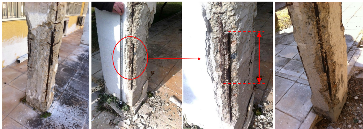
Σχ. 3. Σημαντικές διαβρώσεις και ανεπαρκής μάτιση των οπλισμών σε περιμετρικά υποστυλώματα
