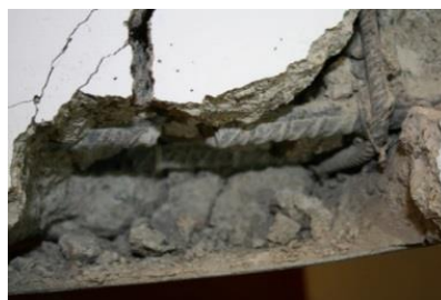
Σχ. 4 Λεπτομέρεια αστοχίας του εφελκόμενου χάλυβα της δοκού REX20-H σε κόπωση
