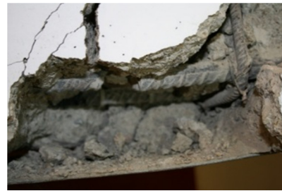
Σχ. 2 Λεπτομέρεια αστοχίας του εφελκόμενου χάλυβα σε κόπωση
