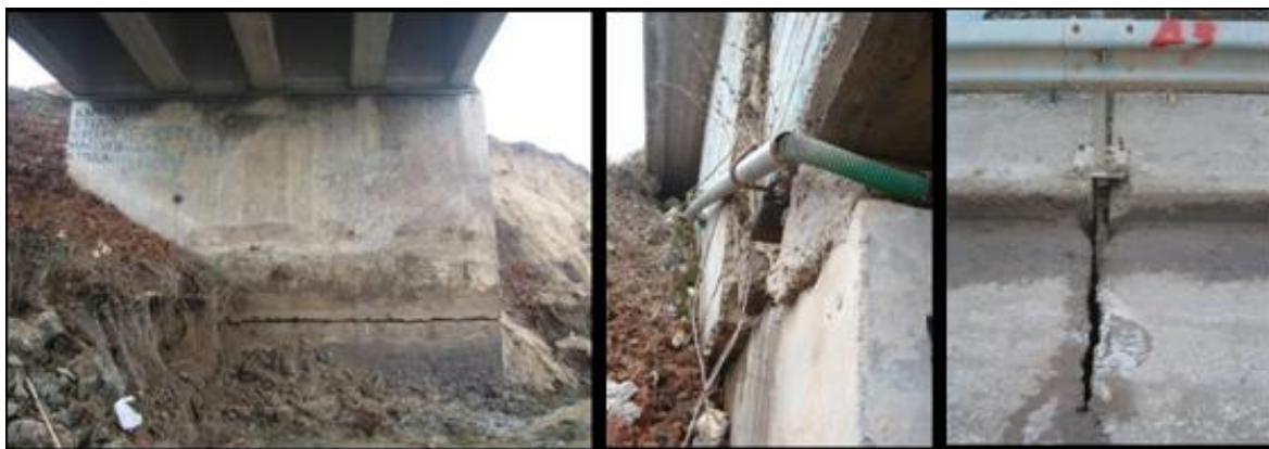
Φωτογραφία 3: Παθολογία τεχνικού. Από αριστερά προς τα δεξιά, α) διάνοιξη αρμού ακροβάθρου, β) μετατόπιση σώματος ακροβάθρου, γ) στροφή ανωδομής στον αρμό μεσοβάθρου.
