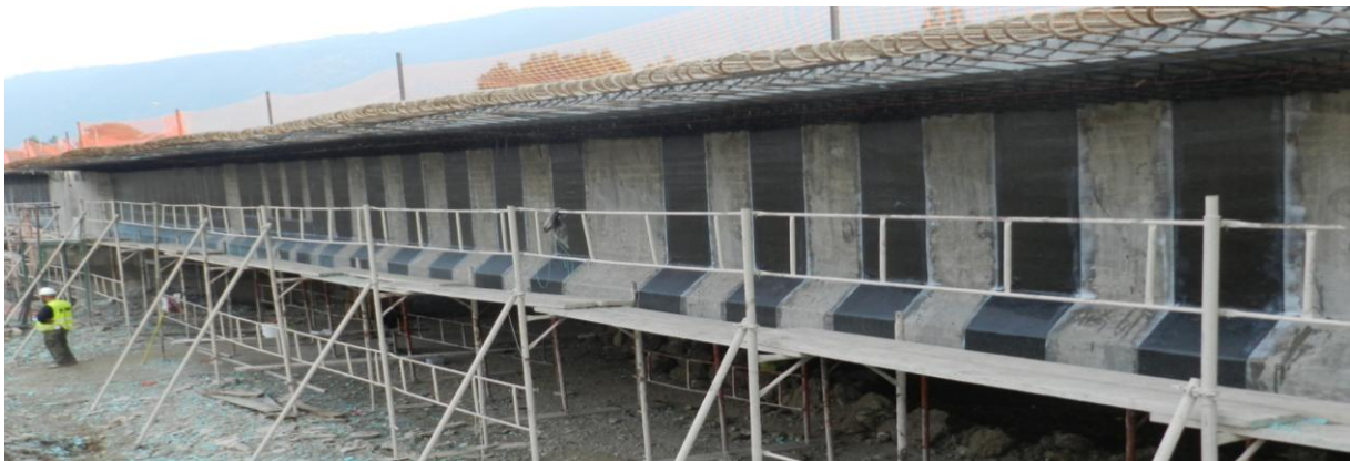
Σχ. 2 – Εφαρμογή ινοπλισμένων πολυμερών FRP για την καμπτική και διατμητική ενίσχυση του φορέα
