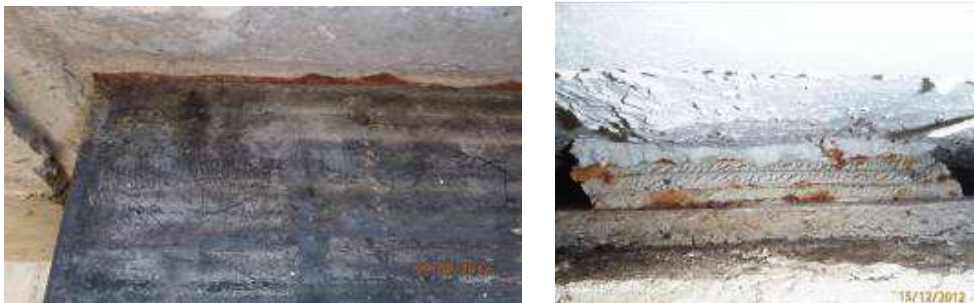
Σχ. 13, 14 . Αστοχία βαφής και έναρξη οξείδωσης μεταλλικών εξωτερικών πλακών αγκύρωσης εφεδράνων τύπου 4 και οξείδωση εσωτερικών πλακών παλιού τύπου εφεδράνου
