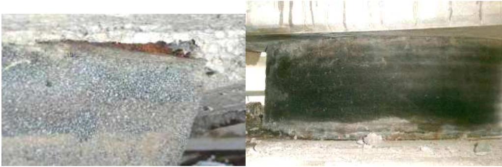
Σχ. 11, 12 . Αστοχίες βουλκανισμού, ενδείξεις οξείδωσης εσωτερικής πλάκας αγκύρωσης
