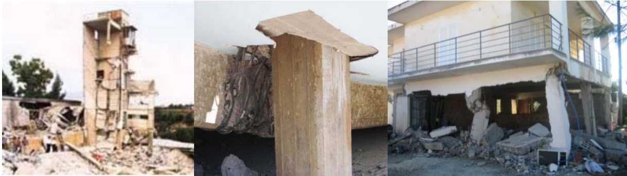
Σχ. 1 Βλάβες και καταρρεύσεις κτιρίων Ο.Σ. στην Ελλάδα μετά από ισχυρούς σεισμούς.
