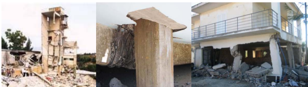
Σχ. 1 Βλάβες και καταρρεύσεις κτιρίων Ο.Σ. στην Ελλάδα μετά από ισχυρούς σεισμούς.
