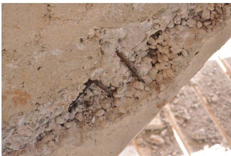
Σχ. 4 Απόμιξη σκυροδέματος σε στύλο μεσοβάθρου.
