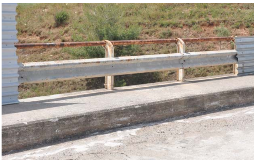
Σχ. 16 Υφιστάμενο στηθαίο ασφαλείας (προς αντικατάσταση).
