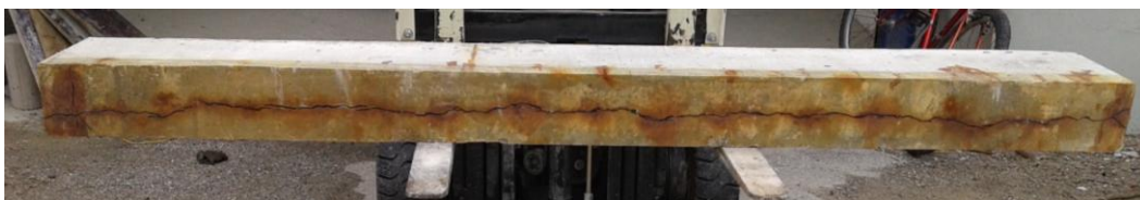
Σχ. 3 Μοτίβο ρηγματώσεων λόγω ελαφράς διάβρωσης m_f=5.7\% κάτω εφελκόμενου πέλματος.
