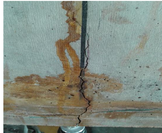
Σχ. 9 Καμπτική ρωγμή και άνοιγμα ρωγμής λόγω διάβρωσης δοκού BC2.
