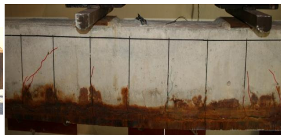
Σχ. 2 Καμπτικές ρωγμές μετά την φόρτιση της διαβρωμένης δοκού στο επίπεδο λειτουργικότητας.
