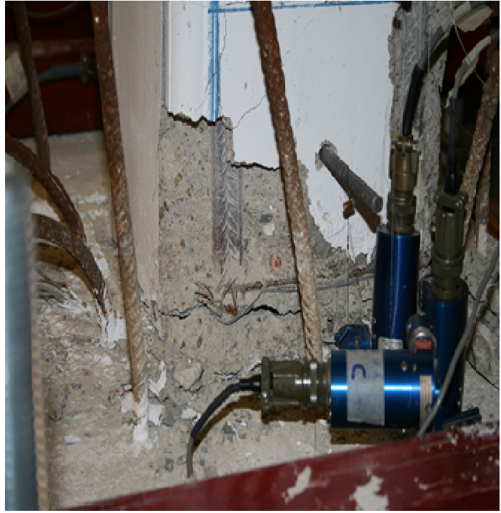
Σχ. 2 Λεπτομέρεια αστοχίας στη βάση του υποστυλώματος
