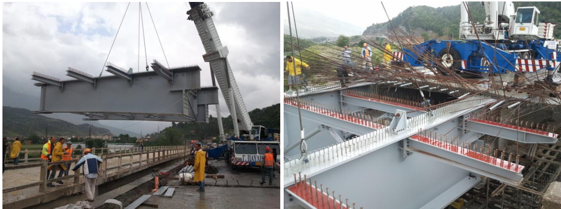
Σχ.5: Τοποθέτηση του πρώτου σπονδύλου του χαλύβδινου καταστρώματος στον κόμβο χάλυβα - σκυροδέματος
