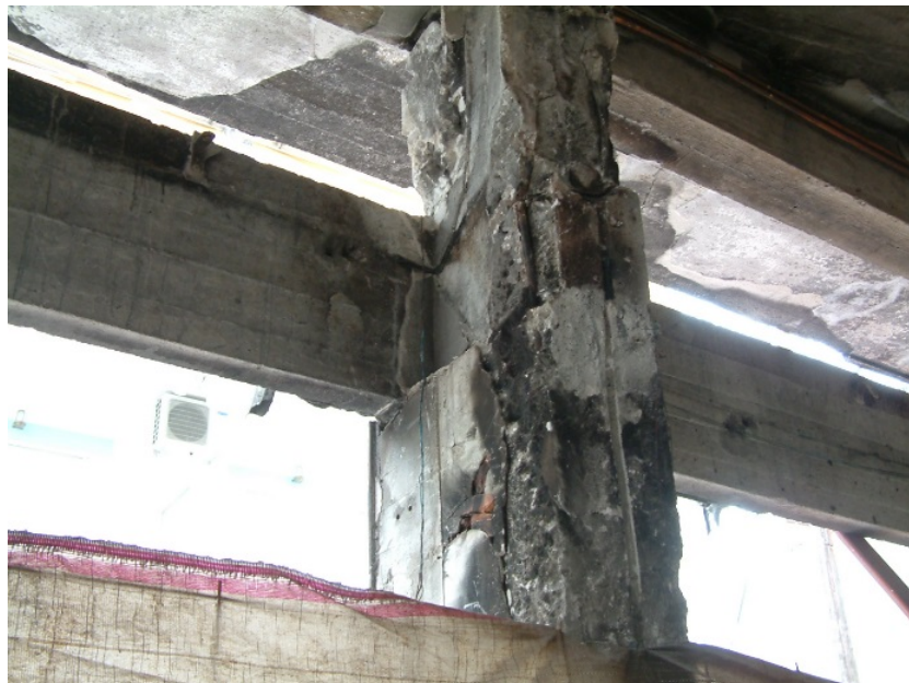
Σχήμα 5. Ανεπαρκείς συνδετήρες και λυγισμός διαμήκη οπλισμού σε υποστύλωμα.
