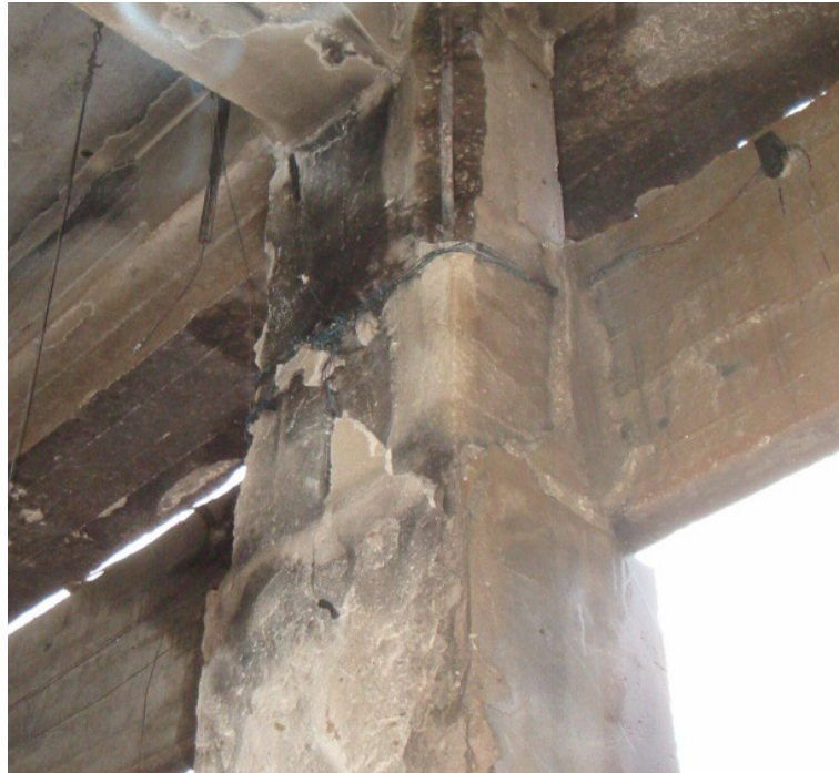
Σχήμα 4. Ανεπαρκείς συνδετήρες σε υποστύλωμα.
