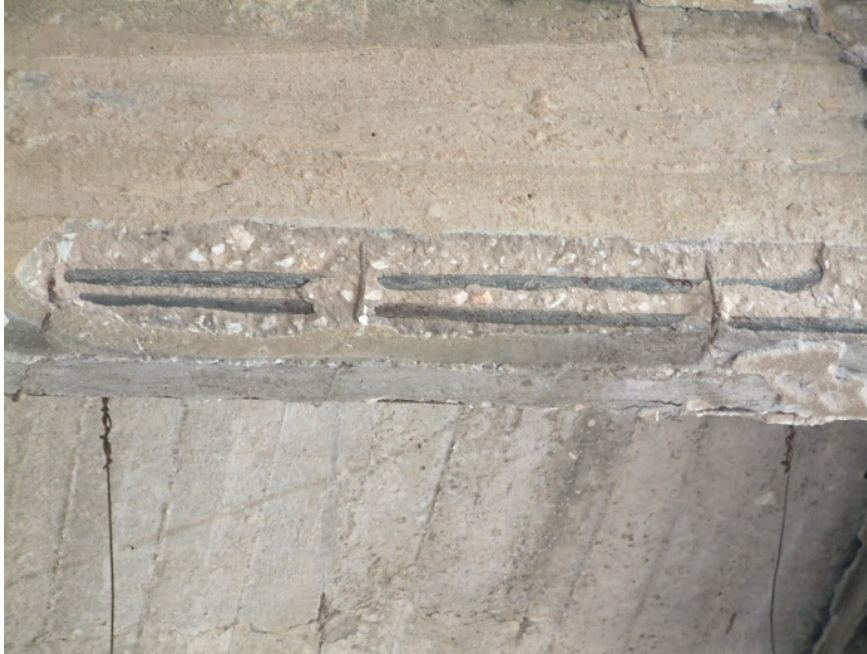
Σχήμα 2. Αποφλοίωση σκυροδέματος σε δοκό.
