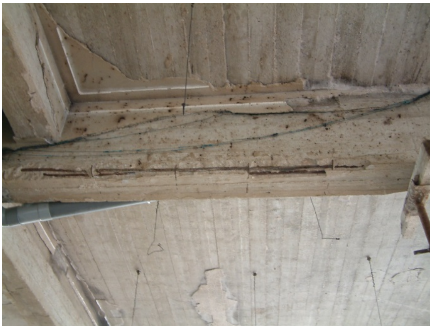
Σχήμα 3. Έντονη αποφλοίωση σκυροδέματος σε δοκό.
