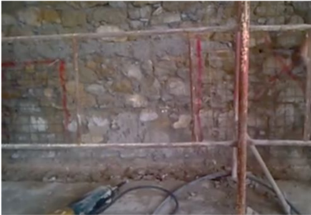
Σχήμα 4: Εργασίες προετοιμασίας της περιμετρικής λίθινης τοιχοποιίας και τοποθέτηση δομικού πλέγματος ενίσχυσης, οπλισμού T139
