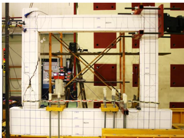
Σχήμα 6. Διατμητική μορφή αστοχίας του πλαισίου ελέγχου (γυμνού, χωρίς ενίσχυση).
