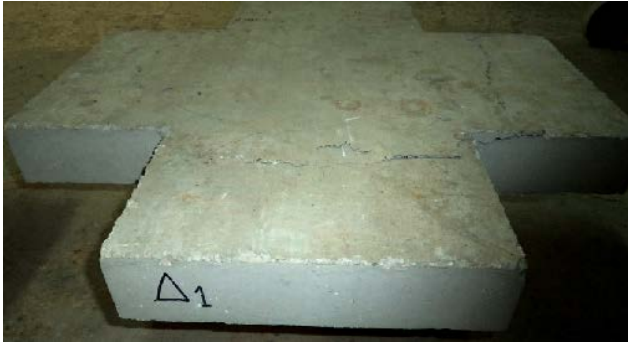
Εικόνα αστοχίας δοκιμίου Δ-1
