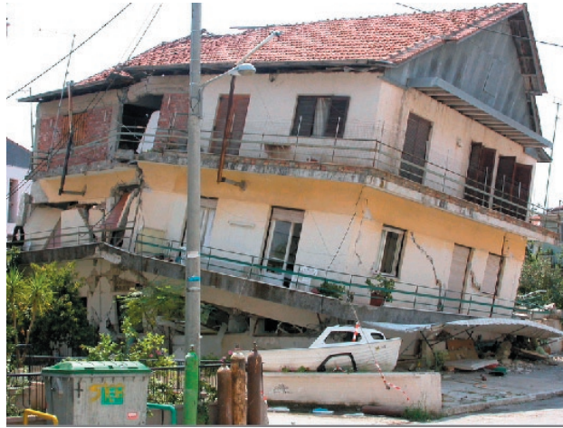
Σχήμα 4: Το κτίριο (τριώροφο+σοφίτα) της οδού Ζαμπέλη που κατέρρευσε
