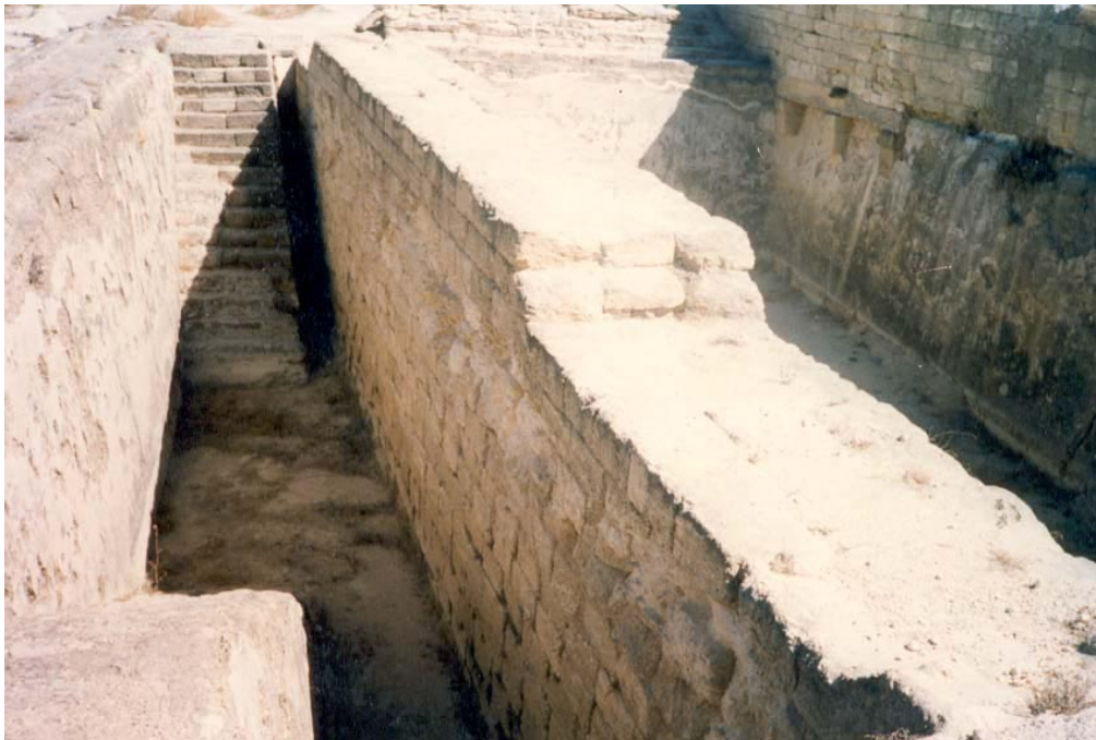
Φωτ. 2: Υδατοδεξαμενή από μπετόν στην αρχαία Κάμειρο της νήσου Ρόδου, με τη λιθοδομή που κτίστηκε αργότερα, κατά τον 3 ο π.Χ. αιώνα σαν βάση «Δωρικής Στοάς» πάχους 1.60 μέτρων, μήκους 200 μέτρων και έτσι αχρηστεύθηκε τότε η υδατοδεξαμενή
